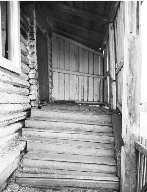
Опасность на подступах к школьным классам — крыльца признаны ветхими. Их состояние видно даже на фотографиях.
